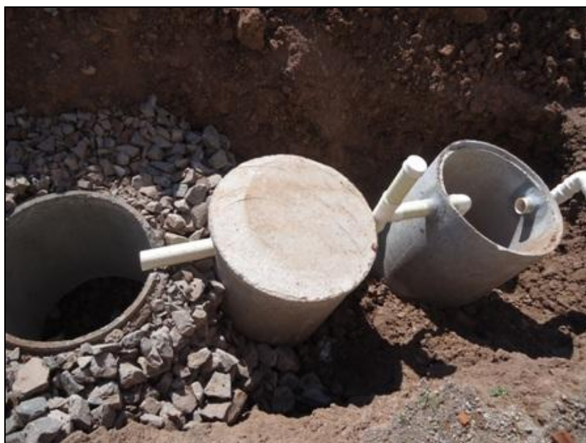
Figura 31 - Sistema de Fossa, Filtro e Sumidouro utilizado nas residências de Guaraciaba Fonte: Acervo Espaço Urbano
