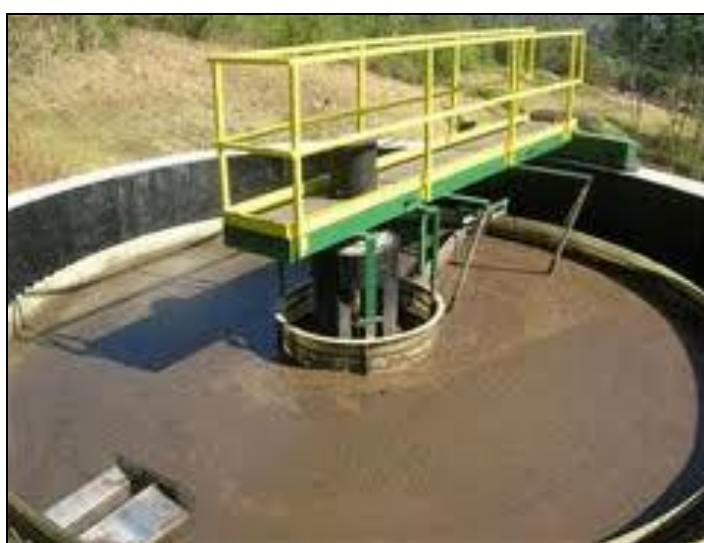
Figura 57- Processo de lodos ativados Fonte: Google Imagens
